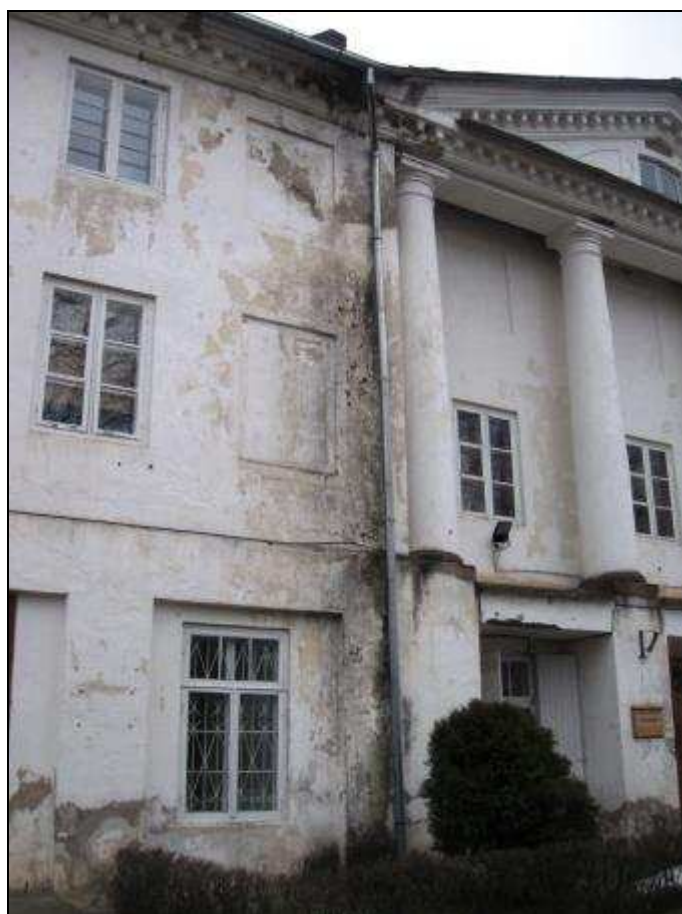
R fasādes fragments – defekts zem jumta plaknes un frontona jumtiņa sadurvietas, IMG_6784
