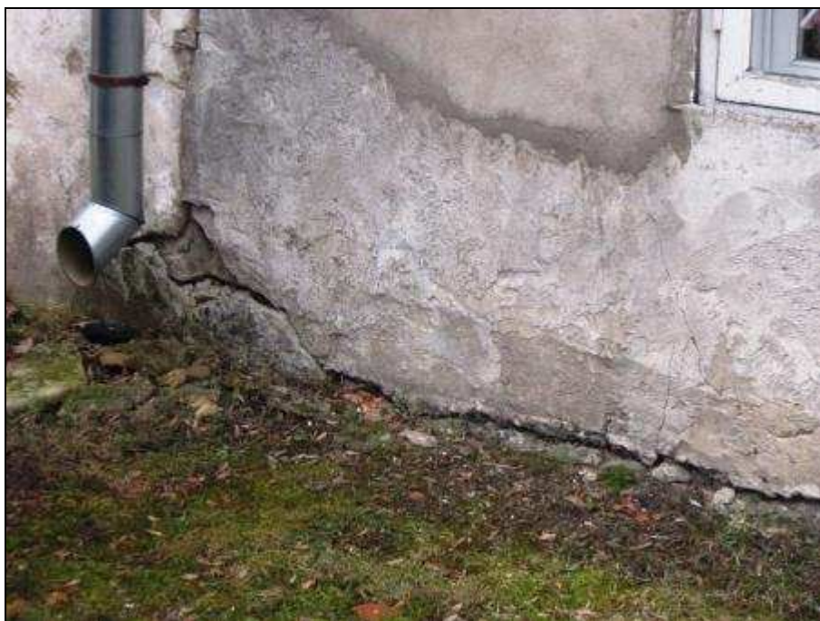
Rietumu fasādes fragments – lietus ūdens izraisīts defekts sienas apakšdaļā, IMG_6781
